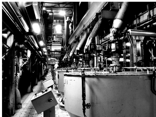
Fig.13 - Nuovi idroestrattori centrifughi continui installati nel 1998
