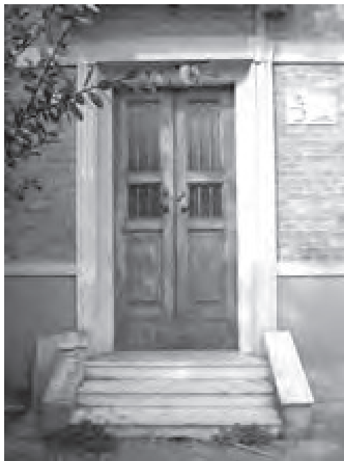
Fig. 41 - Cabina di trasformazione tensione - villino S.E.R.: ingresso principale
