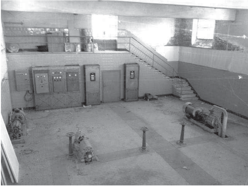
Fig. 5 - L'interno della sala pompe
